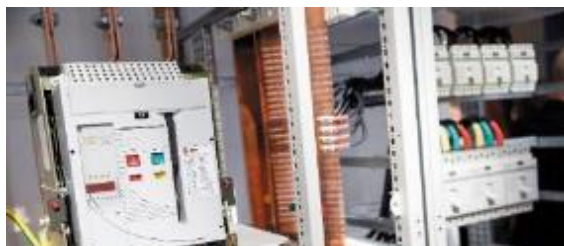
ВВОД И РАСПРЕДЕЛЕНИЕ ЭЛЕКТРОЭНЕРГИИ ДО 1 кВ
